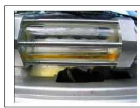
Za duży poziom oleju
